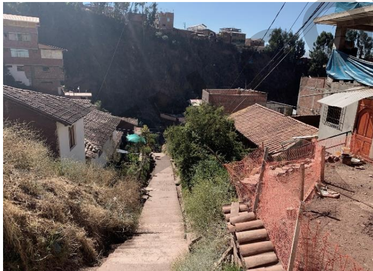
Imagen N° 71: Calle Los Amanques con canales de evacuación de aguas pluviales en mal estado.
