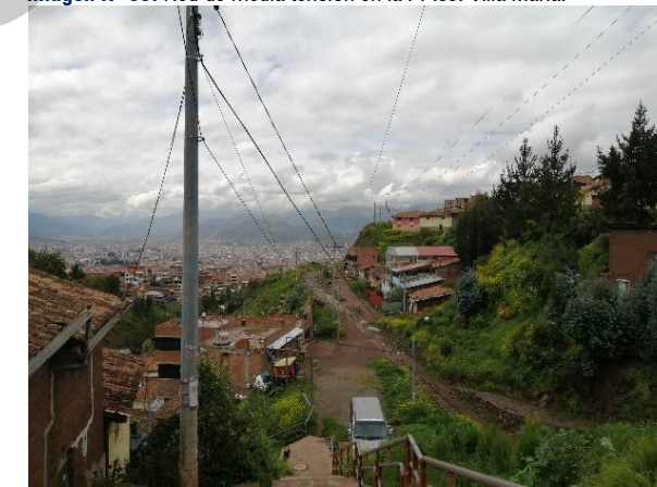
Imagen N° 69: Red de media tension en la PP.JJ. Villa Maria.
